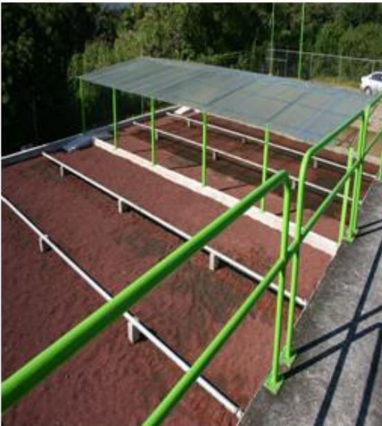
LECHOS DE SECADO DE LODOS
